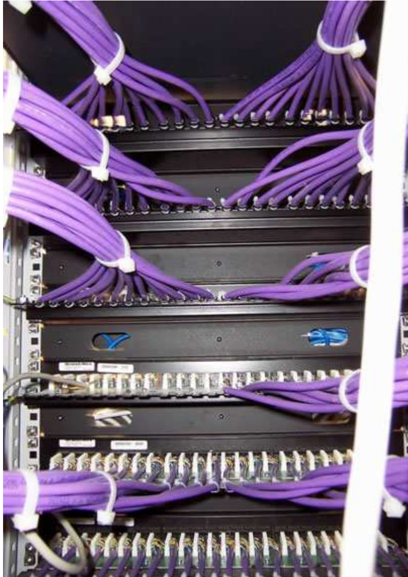
Ejemplo de la parte posterior de un rack conexionado por un técnico de Sylcom Redes y Comunicaciones, S. L.
