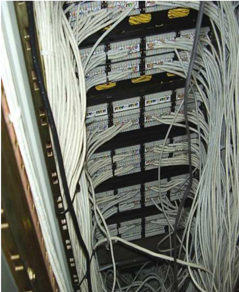
En esta fotografía también podemos observar cómo han sido efectuadas las conexiones en la parte posterior del rack de CLIENTE
